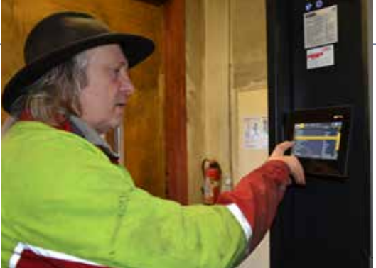
Die neue Heizungsanlage wertet alle Daten auch selbstständig aus und optimiert sich selbst.
